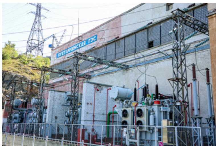
Повышающие трансформаторы играют важную роль в общем процессе производства. Они позволяют получить заданную мощность и передают электроэнергию через распределительные устройства на большие расстояния
